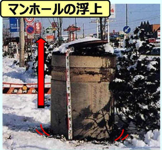
地震による液状化
