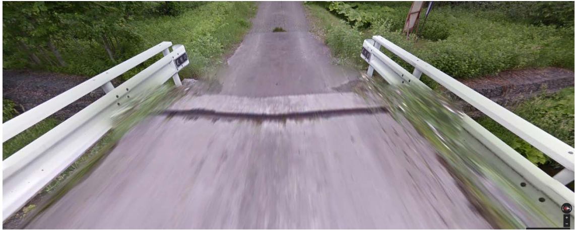
写真-4 被災前の右岸 (出典：Google ストリートビュー 1) ) (右：上流、左：下流)
