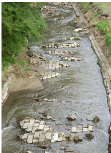
図2 一定間隔での護床ブロックの変状
