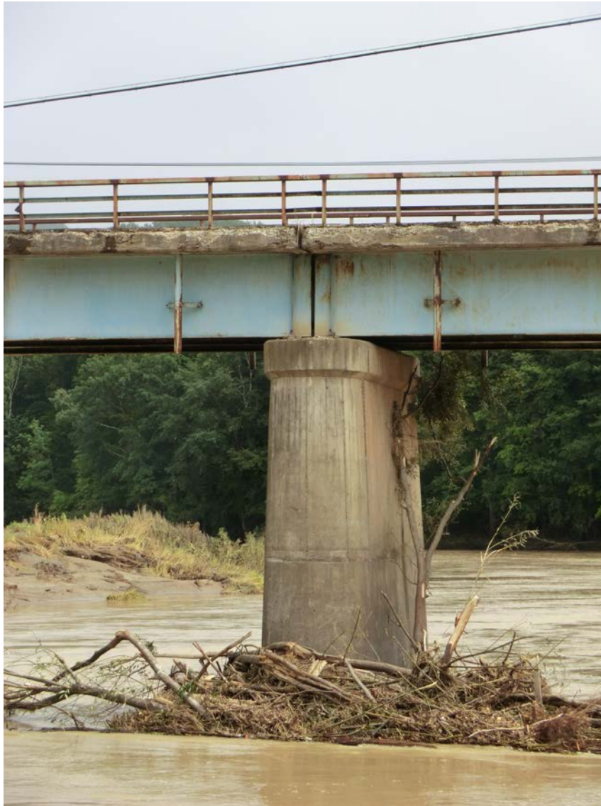
写真-5 橋脚への流木体積状況
