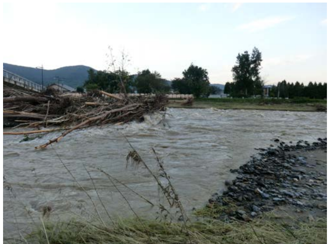
写真-12 P1 橋脚への流木堆積③
