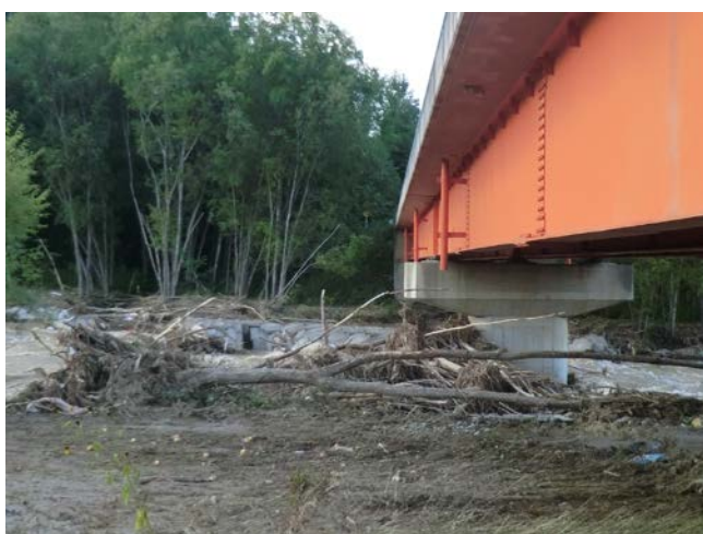
写真-3 P1 橋脚への流木堆積（右岸から撮影）
