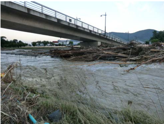
写真-13 P1 橋脚への流木堆積②
