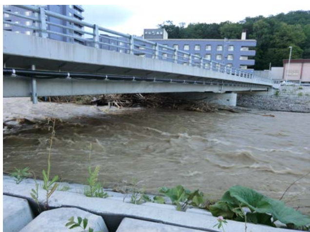
写真-8 P1 橋脚への流木堆積（下流側）
