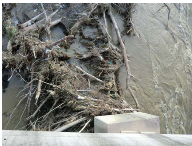
写真-4 P1 橋脚への流木堆積（橋上から撮影）
