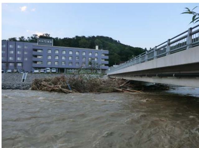
写真-7 P1 橋脚への流木堆積（上流側）
