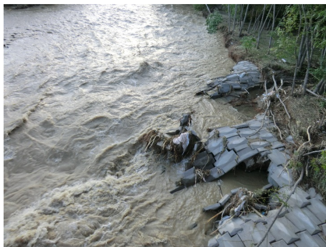
写真-6 左岸護岸の変状（橋上から撮影）
