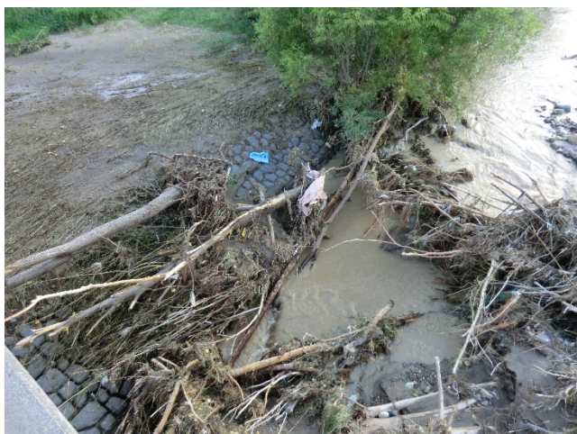
写真-5 右岸の流木堆積（橋上から撮影）
