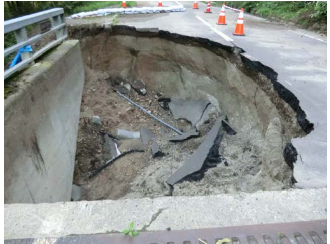
写真-4 A2 橋台背面土の流出状況②
