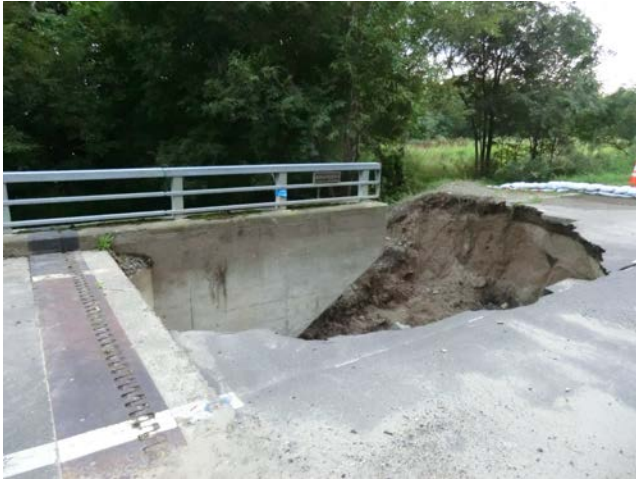
写真-3 A2 橋台背面土の流出状況①
