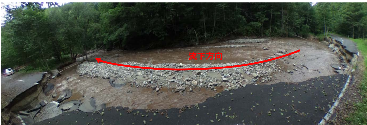
図2 道路崩落箇所（その2）
