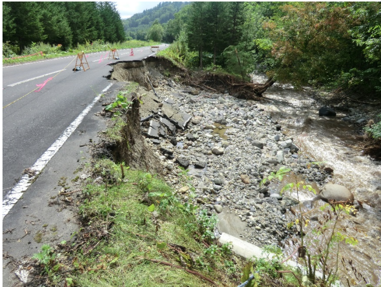
図1 道路崩落箇所（その1）
