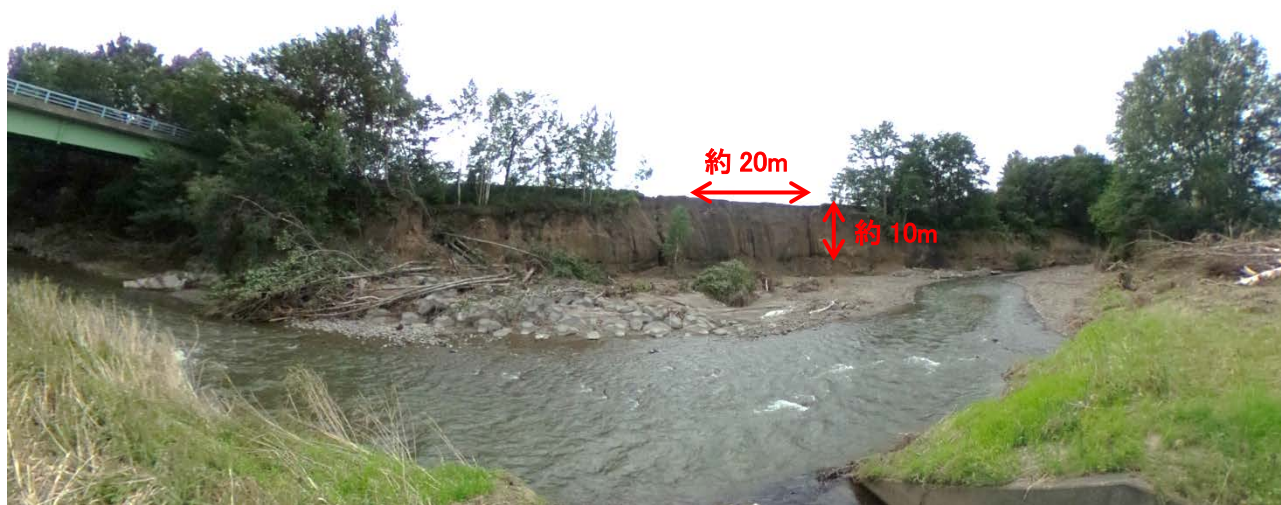
図3 崩落箇所の全景
