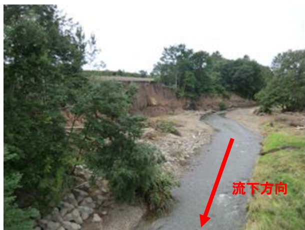
図1 崩落箇所全体（橋梁上から撮影）
