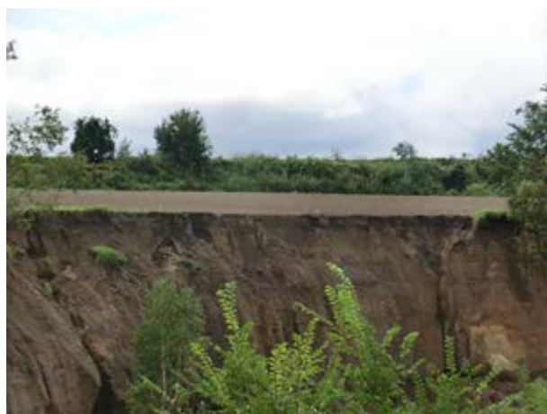
図2 畑地の崩落箇所
