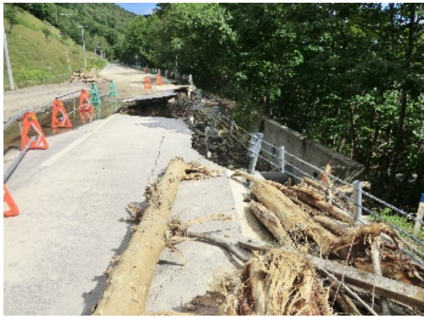
図1 道路崩落箇所
