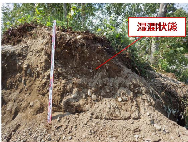
図3 上流方破堤断面の状況
