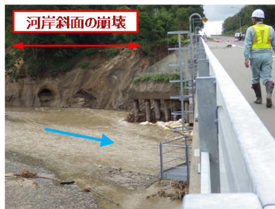
図2 左岸河岸斜面の崩壊状況
