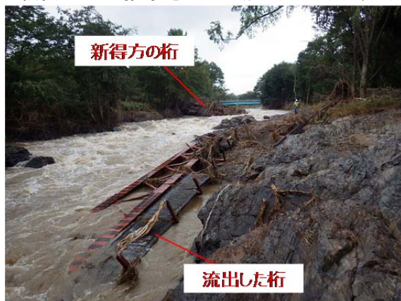
図1 流出した桁の状況
