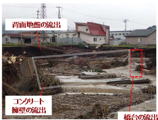
図3 橋台背面地盤の流出状況
