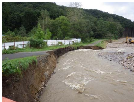
図2 左岸側堤体の浸食状況
