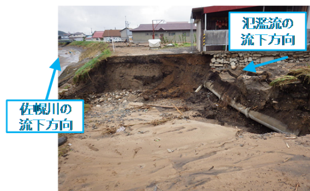
図4 氾濫流による佐幌川右岸護岸の浸食崩壊
