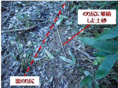
図1 KP42.2裏のり尻の土砂流出
