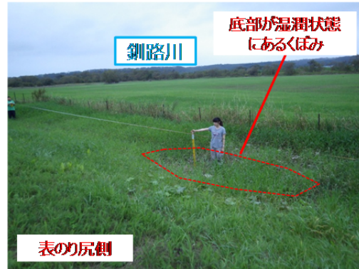
図2 堤外側のくぼみの状況
