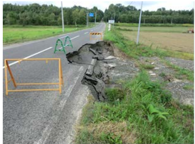
図2 道路損傷箇所
