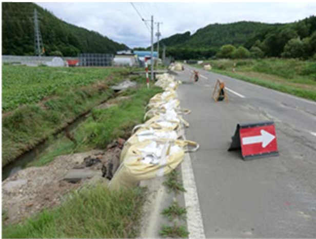
図2 被災箇所①
