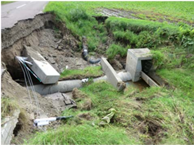
図4 被災箇所上流側
