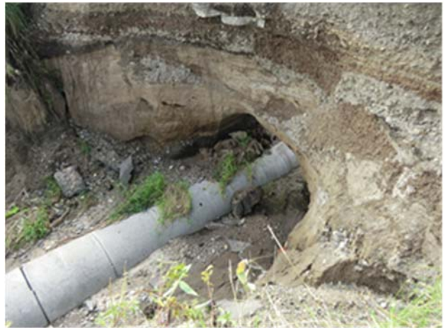
図5 被災箇所下流側
