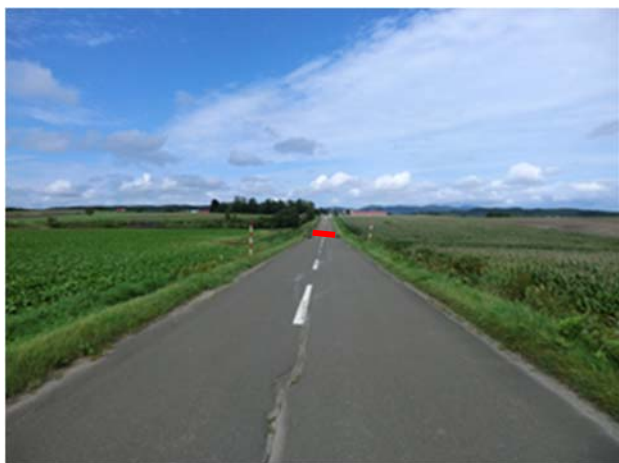
図2 被災箇所全景（南側から撮影） 赤線が被災箇所
