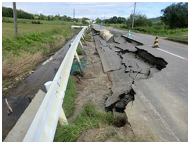
図2 道路の崩落状況
