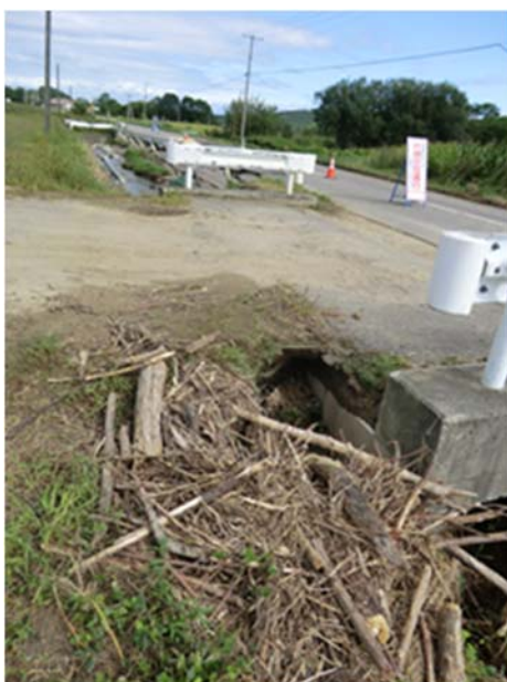
図3 ボックスカルバートの背面土流出 （奥が道路崩落箇所）
