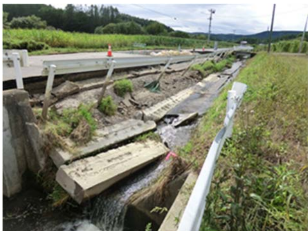
図1 被災箇所全景
