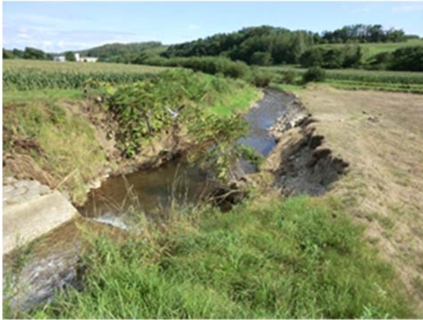
図4 支川被災箇所全景
