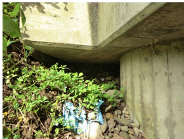
図8 橋台背面土の部分的流出
