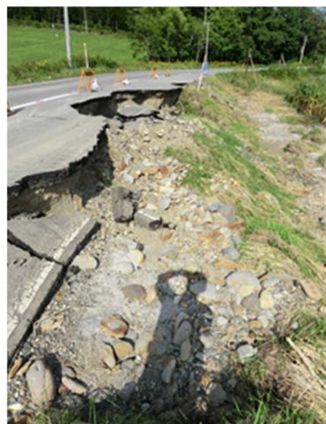
図3 道路被災箇所（西向きに撮影）
