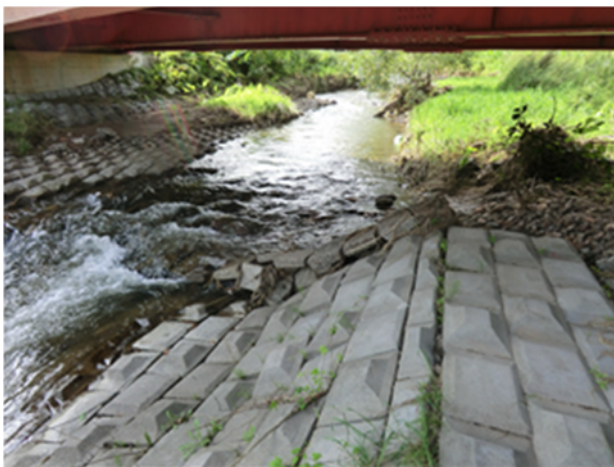
図6 本川護床ブロックの変状
