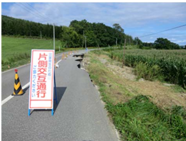
図2 道路被災箇所全景（西向きに撮影）
