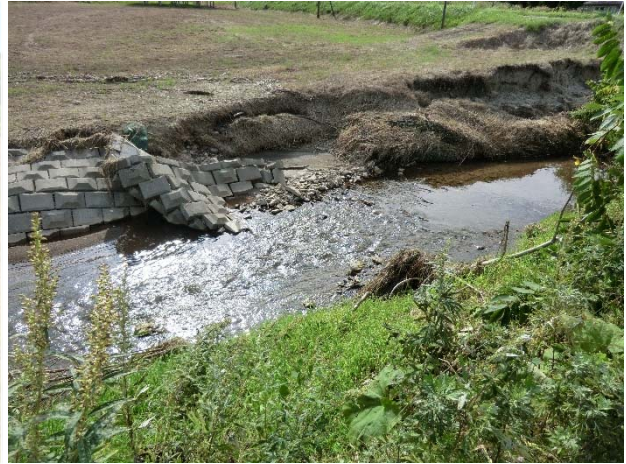
図5 支川の河岸浸食と護岸ブロックの変状
